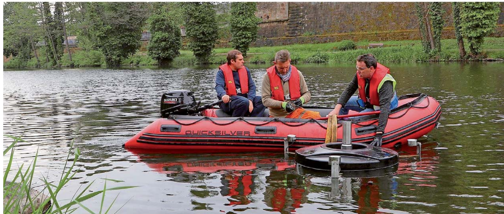
Nachdem das alte Pumpensystem in die Jahre gekommen war, wurde die Fontaine auf dem Saaraltarm durch ein neues System an gleicher Stelle ersetzt.
